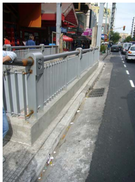
Foto 13 - Problemas con el cordón.
